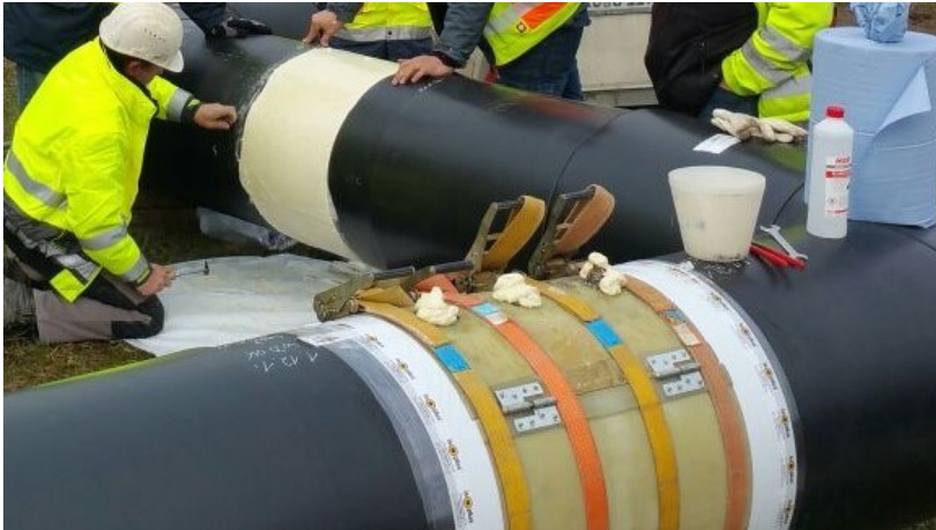
Foto/Quelle: STURM Isotech
